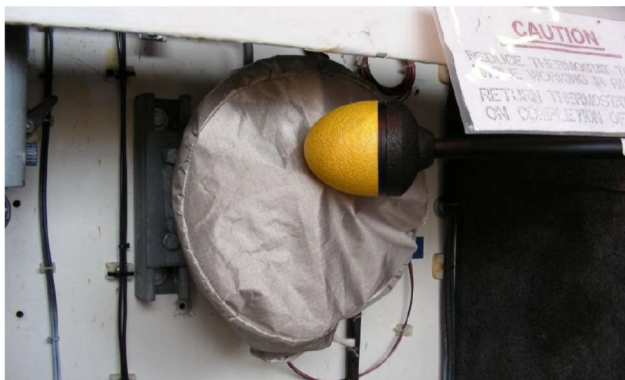
Figura 33 - Blindagem para EMI cobrindo um transmissor instalado num ambiente de sinal wireless (AMS, 2016)
